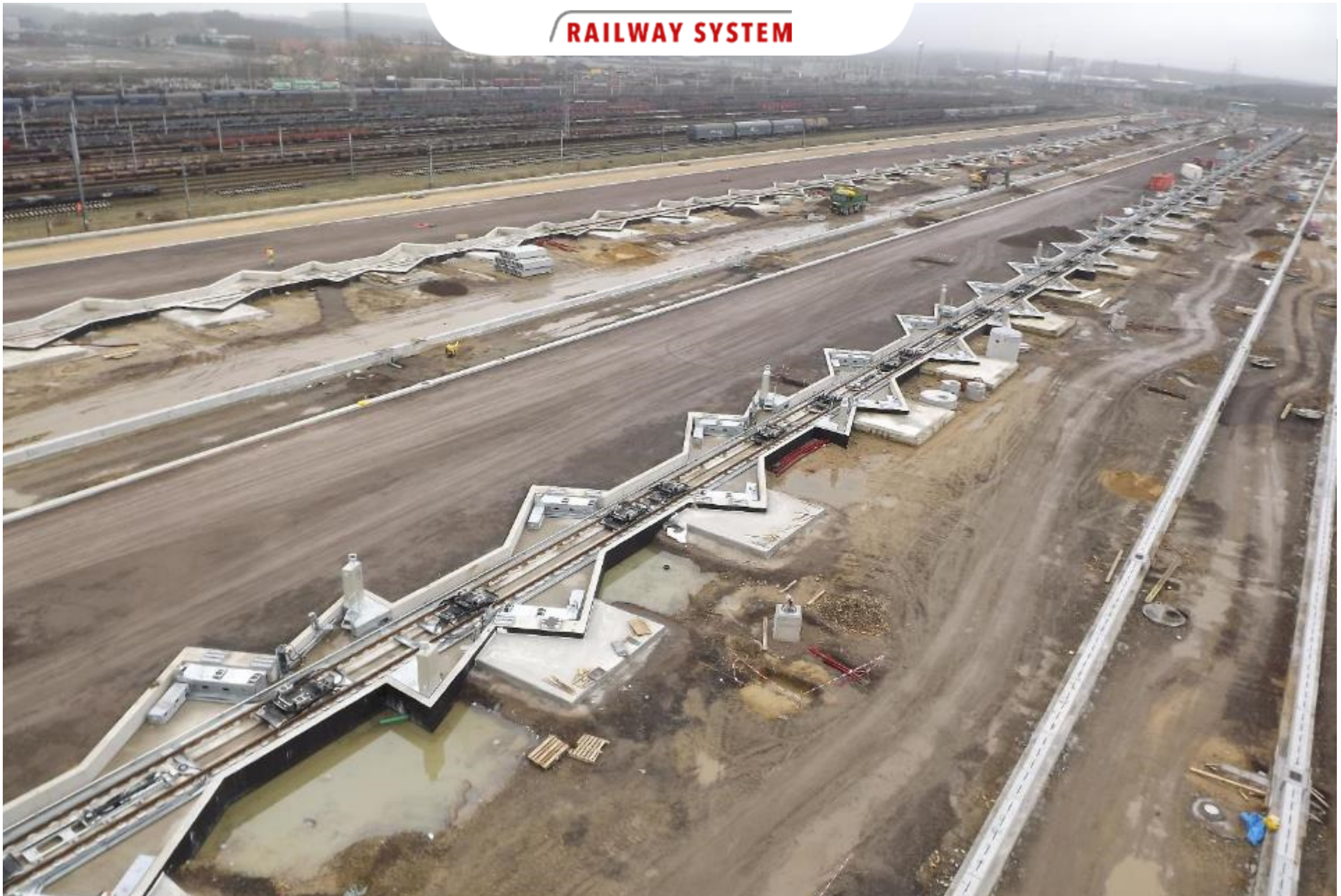
Terminal von Dudelange, 2 x 42 Stationen
