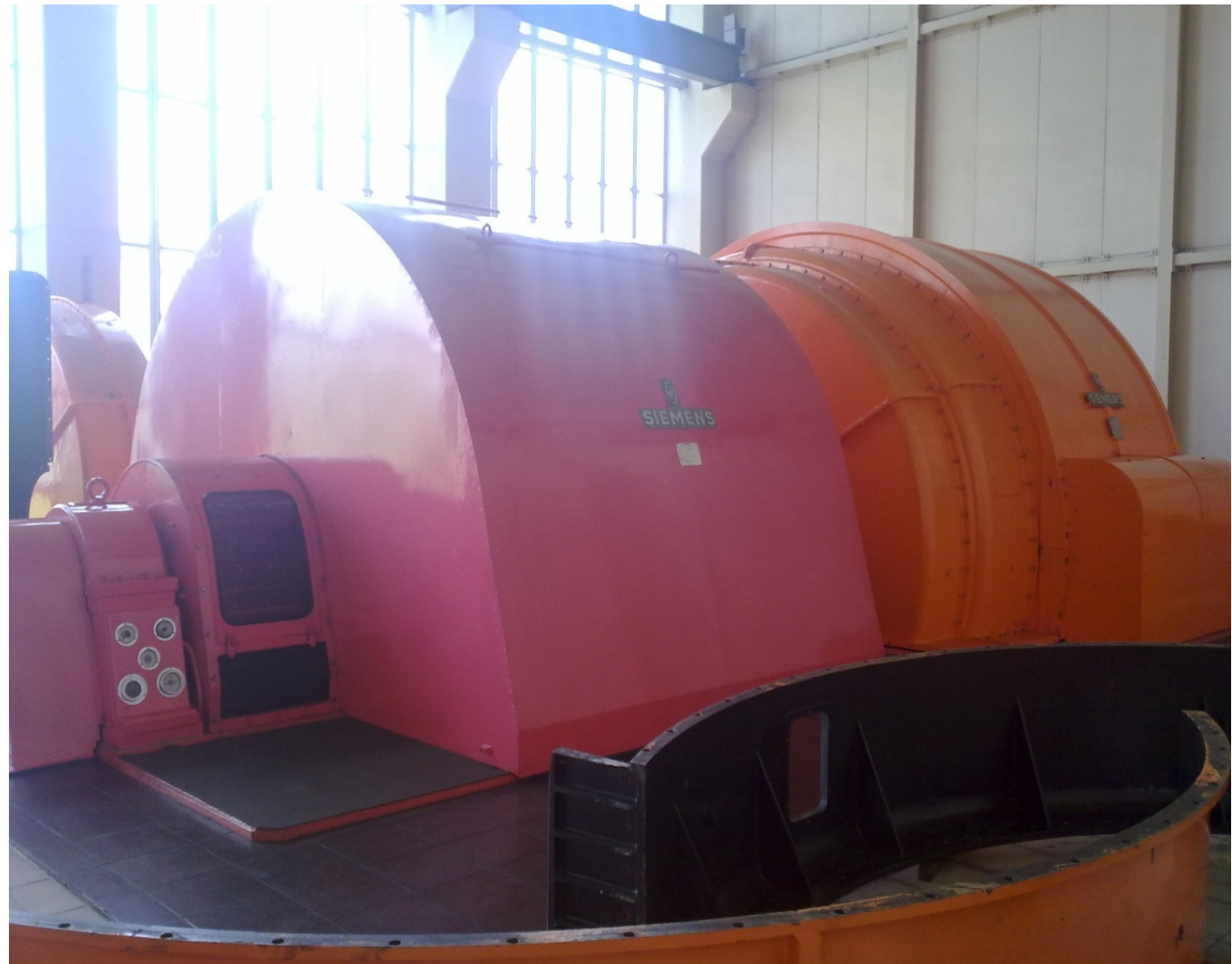
Umformer Karlsruhe E2
