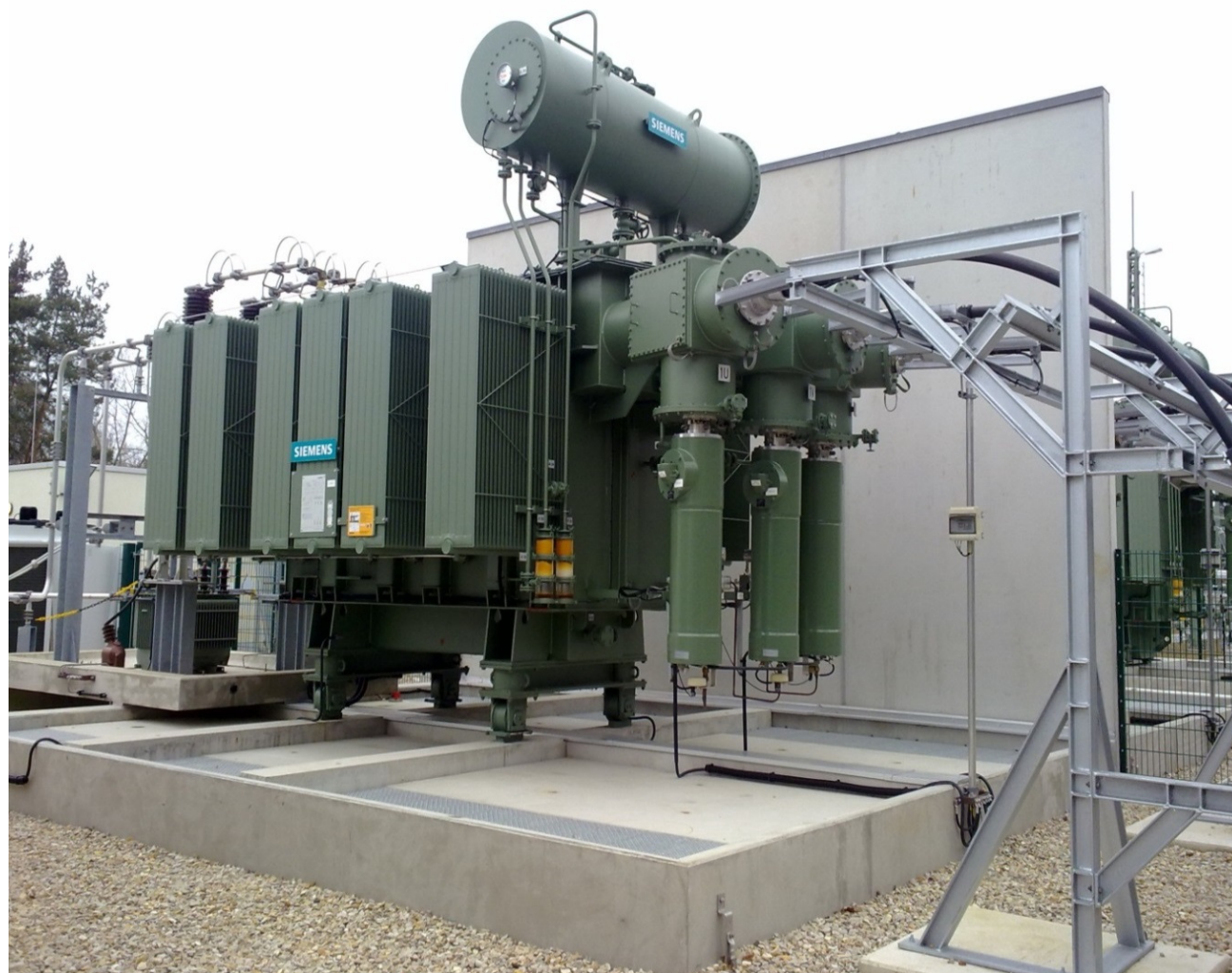
Umrichterwerk Nürnberg, 50-Hz-Einspeisung
