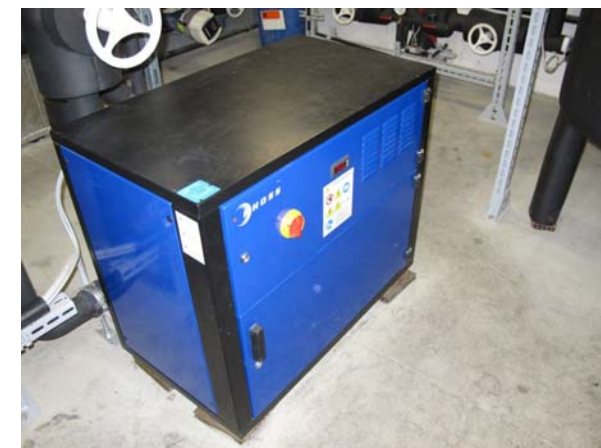
Kältemaschine U2 Taborstraße: 50 kW Kälteleistung, 15 kW Leistungsaufnahme
