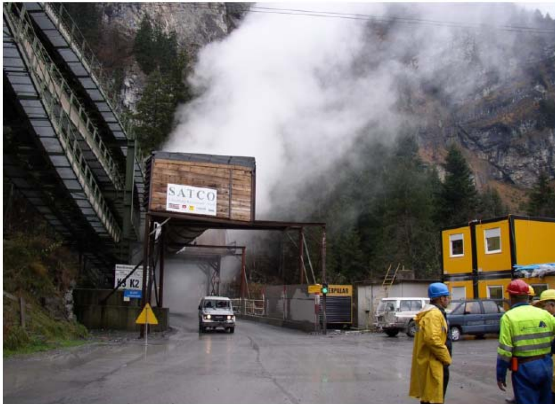
Portal des AlpTransit Lötschberg-Basistunnels in Frutigen (Schweiz) - Nutzung der warmen Tunnelwasser zur Störzucht
