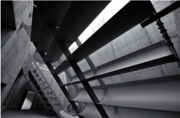
Abbildung 5a+b: Die Luftmenge, die die Ventilatoren fördern, wird über eine Drehzahlregelung, die mit Hilfe von Frequenzumrichtern realisiert wird, und über die Laufschaukelregelung angepasst. Dabei wird mit Hilfe einer Hydraulik durch unterschiedliche Öldruckvorgaben der Anstellwinkel aller Laufschaukeln synchron im Betrieb verstellt. Quelle: Alp-Transit Gotthard AG
