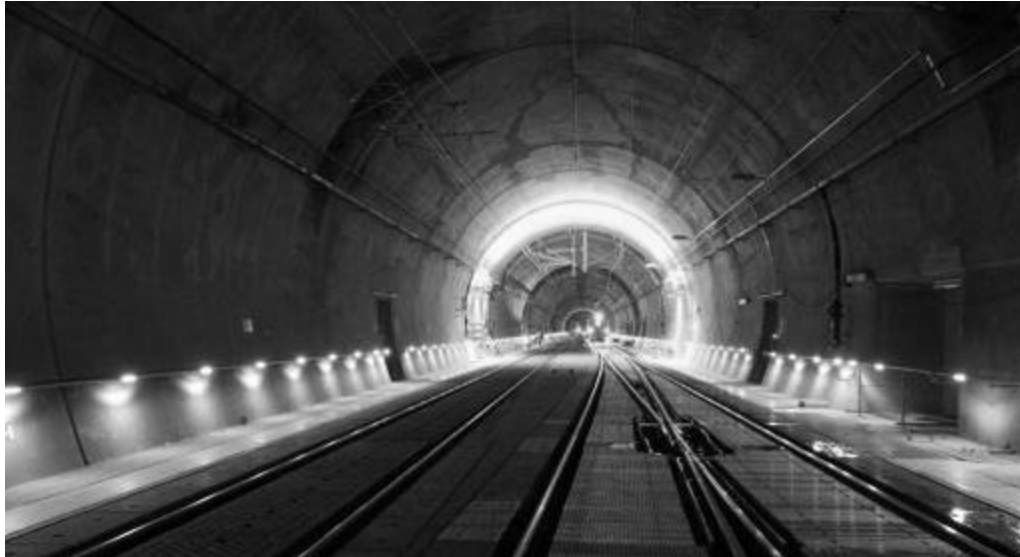
Abb. 6. Tunnelringbeleuchtung im Wienerwaldtunnel
