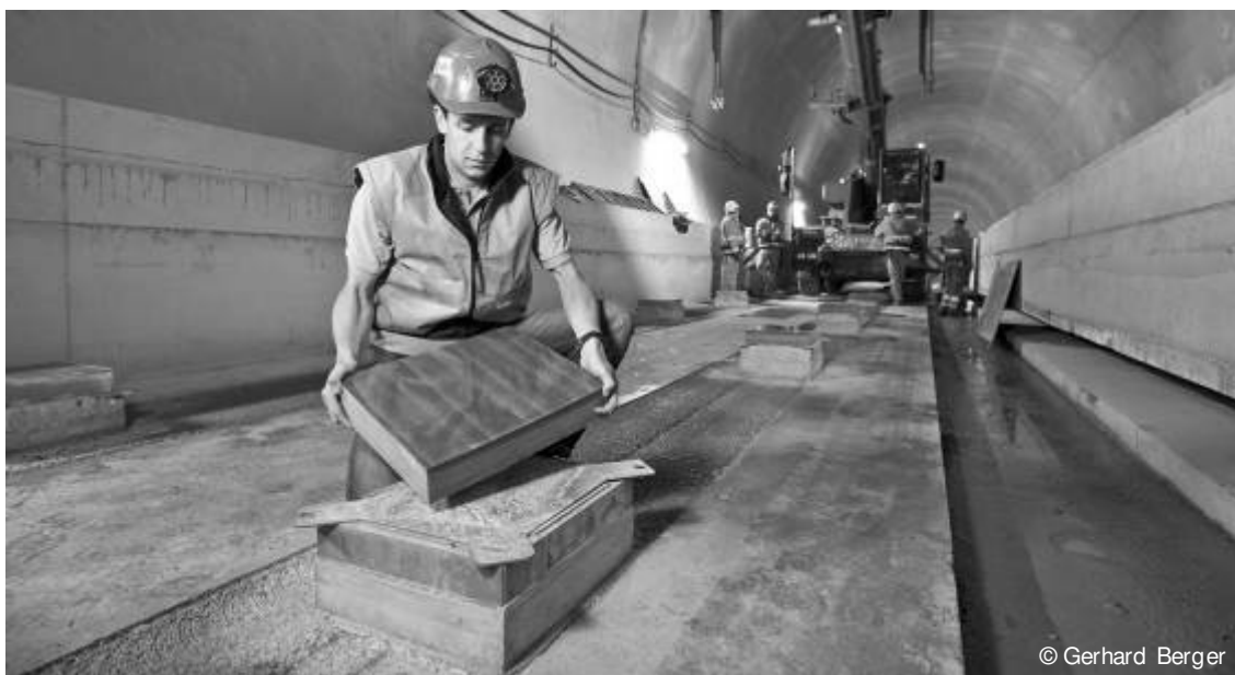
Bild 5: 24 Kilometer Masse-Feder-Systeme sichern einen optimalen Erschütterungsschutz für die Anrainer der neuen Bahnanlagen.
